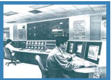
台塑集團六輕廠區最現代化的數位電腦控制室
