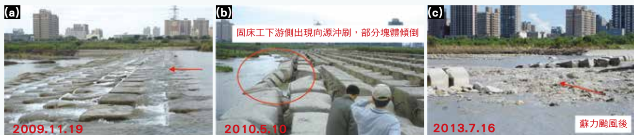
新竹頭前溪隆恩堰下游 800 公尺固床工的歷史沖刷破壞過程
