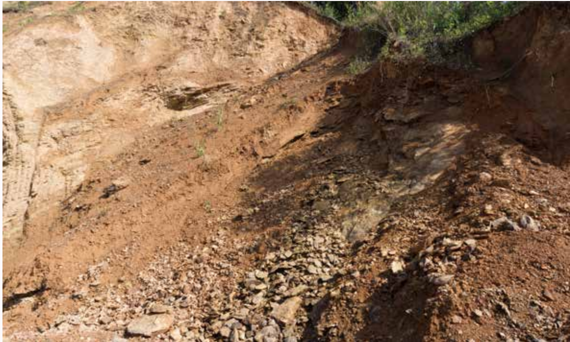
強降雨造成山坡地無法負荷，易造成大規模崩塌。（圖片來源：種子發）
