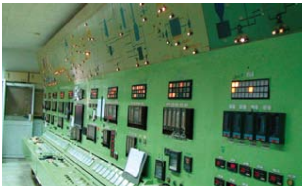
早期肥料生產邏輯控制系統（PLC）
