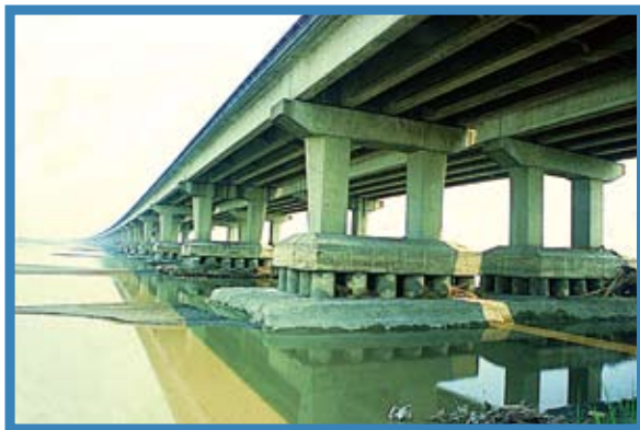
龐大的RC建築物市場造成嚴重橋梁破壞的情形
