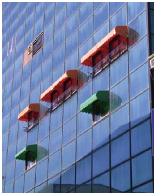
玻璃大樓的室內炎熱不堪而改裝外遮陽設施的情形
