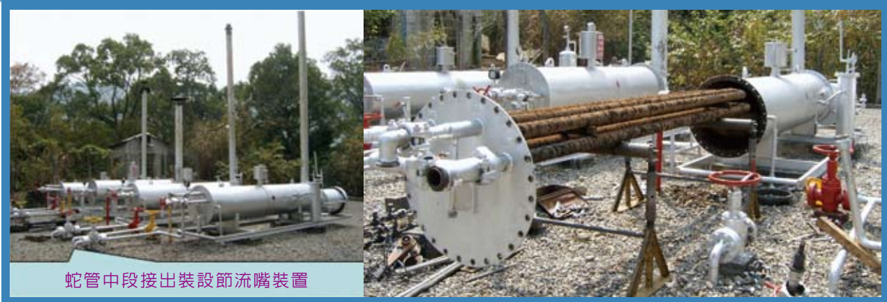
(左) 4組加熱器並排分別加熱4口井的天然氣。(右) 加熱器內部蛇管取出檢修。
