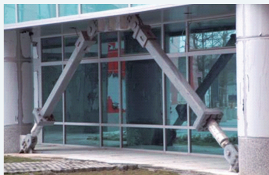
安裝在房屋結構上的黏滯型阻尼器
