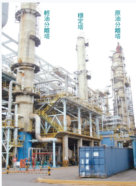
石油（原油）蒸餾工場。
