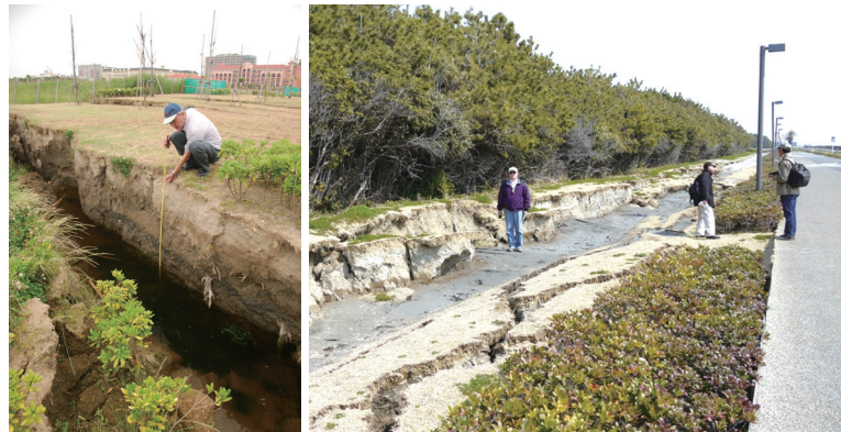
浦安市濱海公園側濱最大裂縫寬約 2.5 公尺，最深處達 2 公尺。
