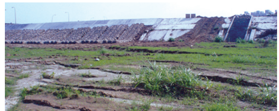
土壤液化引致貓羅溪河岸地盤側向流動破壞
