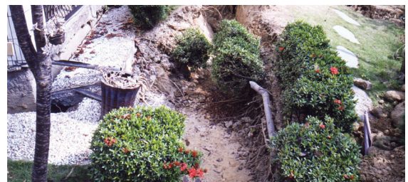
土壤液化引致台中霧峰地區地盤側向流動的地裂情形
