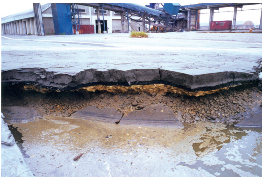
集集地震土壤液化造成台中港碼頭作業區積砂
