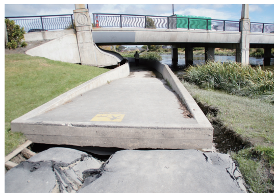
Avon 河附近大規模側潰引致路面嚴重損壞與橋基移位
