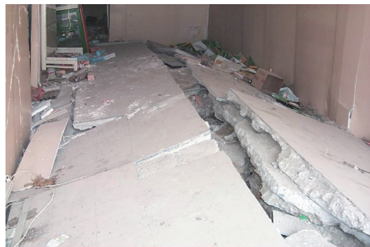
集集地震土壤液化造成房舍沉陷而使底板隆起破壞
