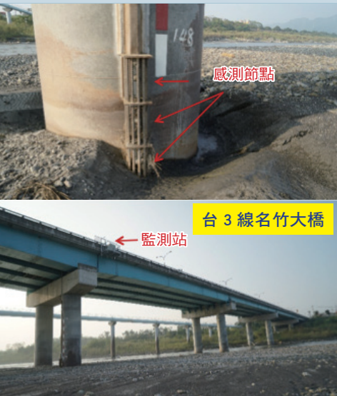
橋墩沖刷監測系統
