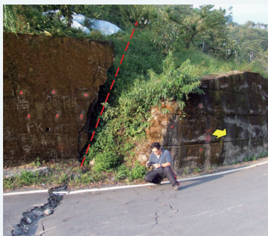
左下角的新生裂縫顯示右側已滑動約 20 公分。舊有且應鄰接的擋土牆已錯移超過 100 公分，暗示可能已累積多次的滑動紀錄。
