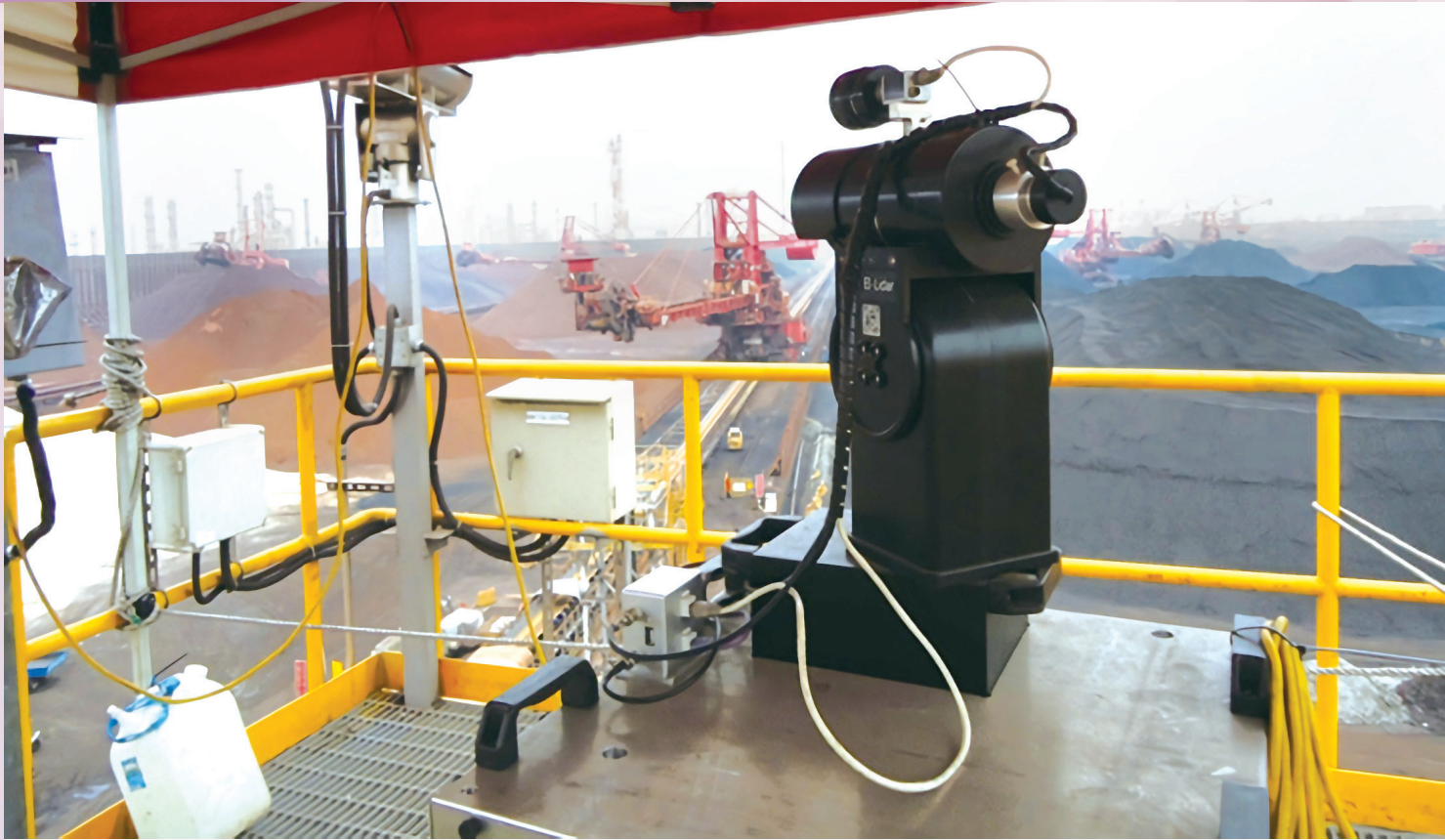
架設於料堆場的光達監測系統
