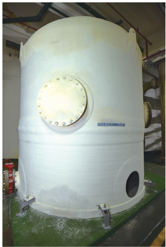
大洋池臭氧接觸槽
