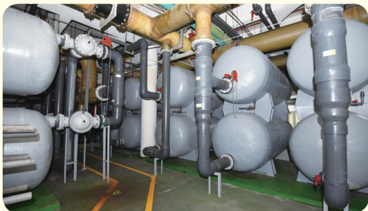
大洋池的高壓石英沙過濾器
