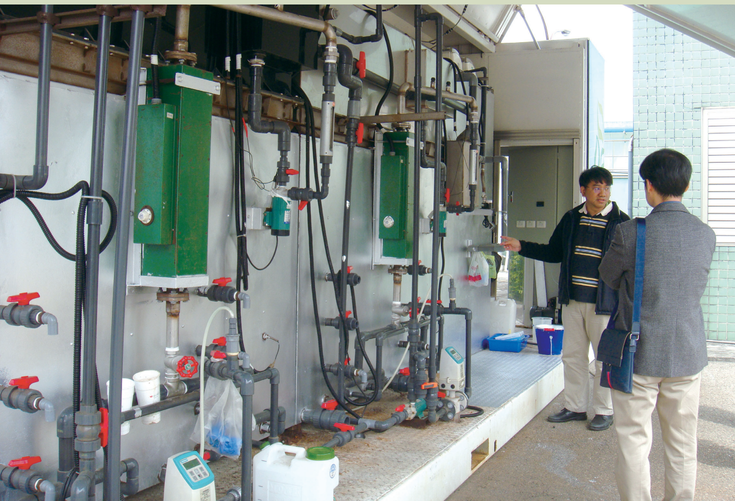
圖中設備是綠能中心開發的模組，其中的主要設備是發酵槽，槽裡的溫度、酸鹼值和氧化還原電位 3 個參數若能調控在最佳範圍內，就能讓槽裡的細菌快速地排放氫氣。
