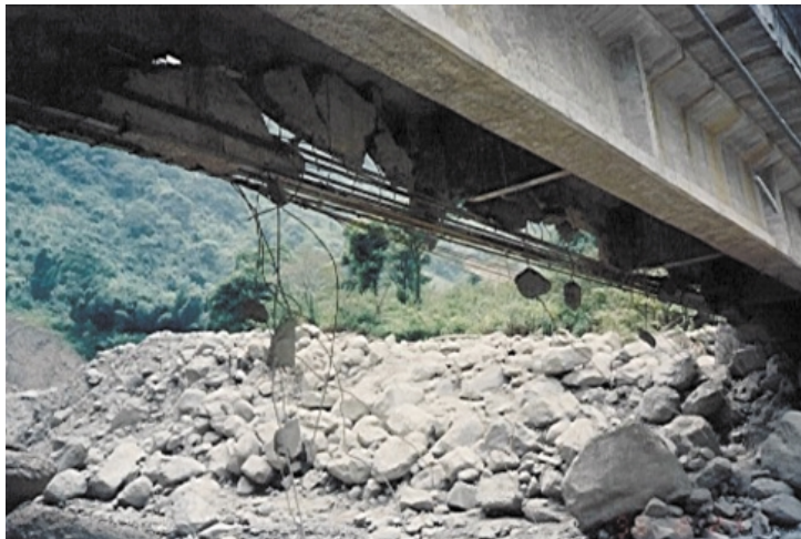
土石流衝擊 橋梁高度不足被土石撞擊，使得橋面下的水泥崩落，鋼筋裸露。
