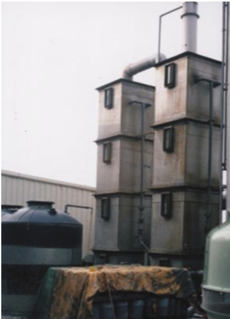
每分鐘可處理一百立方公尺食用油壓榨廠排氣的化學洗滌塔。左塔是第一段洗滌塔，洗滌液是次氯酸鈉溶液；右塔是第二段洗滌塔，洗滌液是亞硫酸氫鈉溶液。
