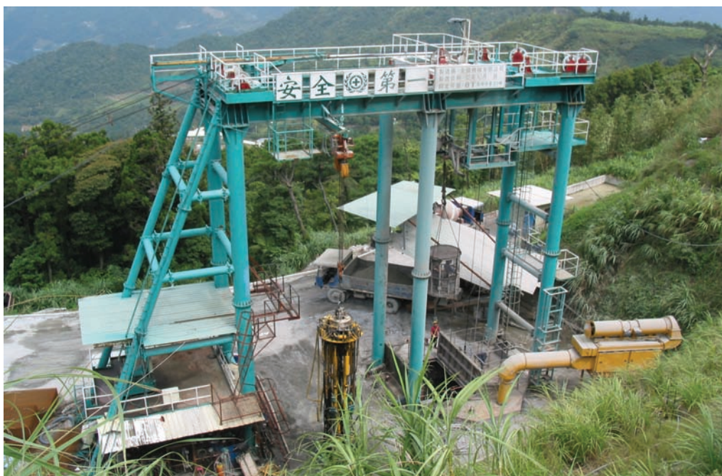
豎井地面門型吊車
