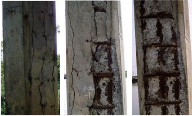
橋墩在不同時期的鋼筋腐蝕膨脹而造成混凝土保護層剝落，鋼筋腐蝕後其有效承受力量的斷面積會減少。
