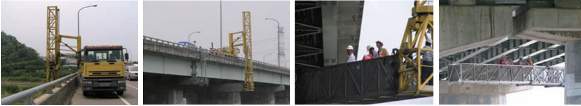
跨越河川或深谷的橋梁，橋面板正下方區域的檢測維修可使用特殊的橋梁檢測車伸入工作。
